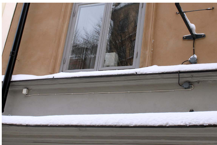
Eldragningen nedan hade varit mycket mindre iögonfallande om kabeln hade löpt längs undersidan av frisen, och om kabel och dosor målats i väggens kulör.
